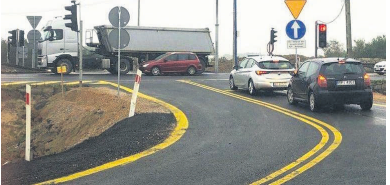
Na Twardosławickiej na razie zostanie zamknięty przejazd dla pieszych pod wiaduktem. Z kolei nowy obiekt przy Wojska Polskiego będzie oddany do użytku w lipcu.
